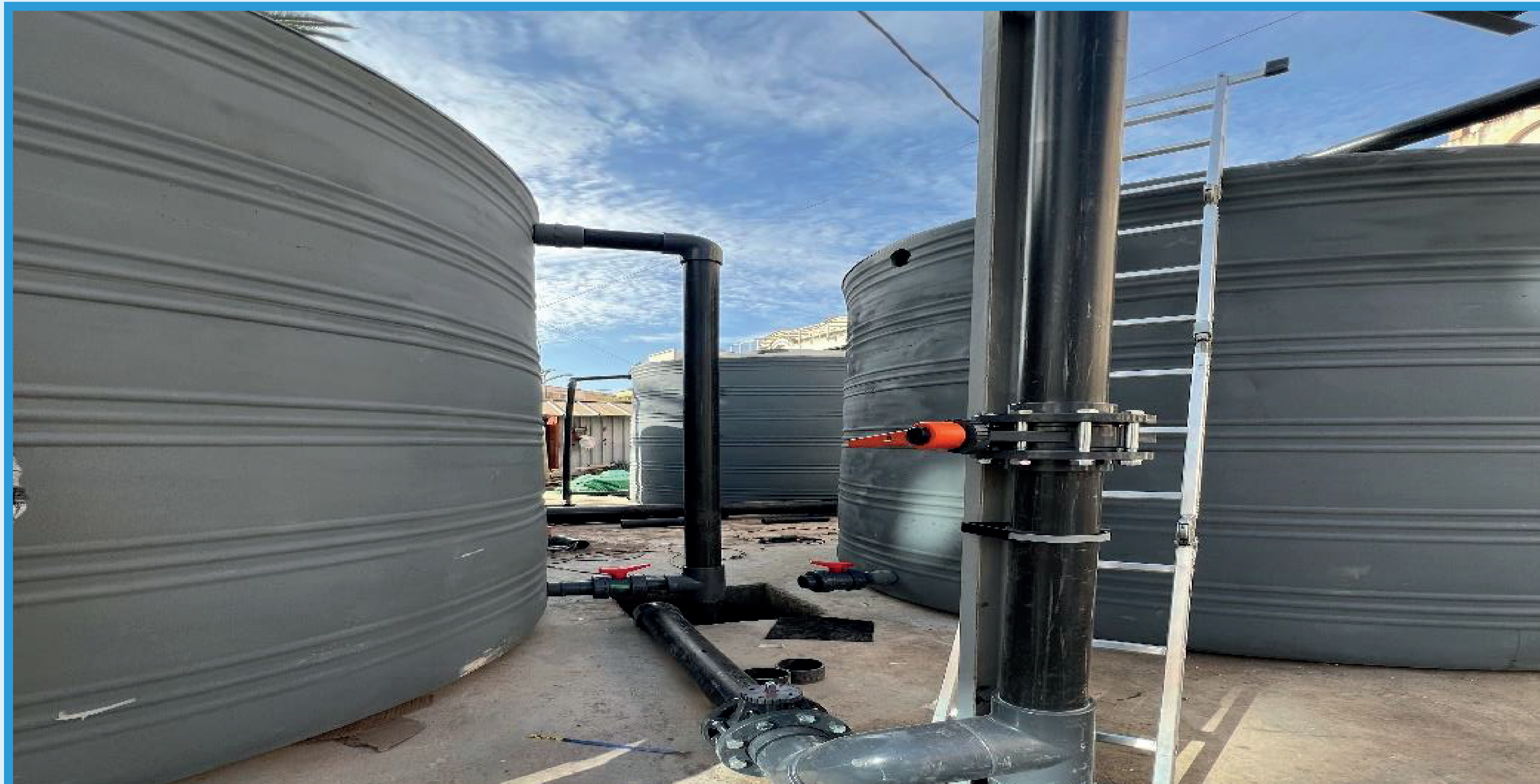
صهاريج تخزين المياه الخام و المياه المعالجة
